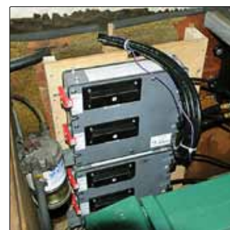
Manöverboxarnas placering i motorrummet.
