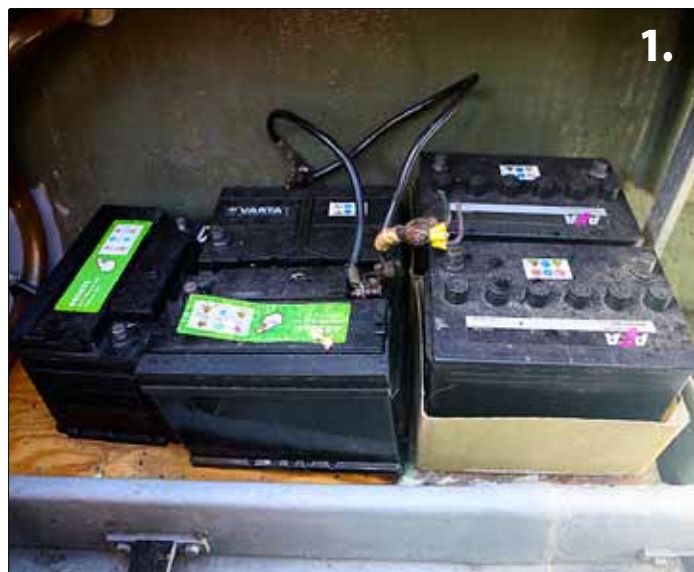
1. Den gamla batteribanken tog upp en stor del av motorrummet i vår Coronet 24. Fem stora ”klumpar” från olika tillverkare och med varierande ålder och kapacitet, kläna kablar, oskyddade batteripoler och en undermålig fastsättning. Så här ser det tyvärr ut i många äldre båtar.
