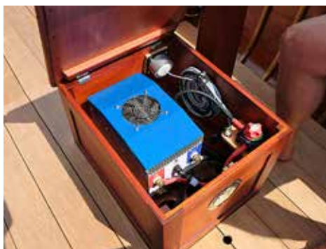
I motorbrunnen syns främst en stor omvandlare.
