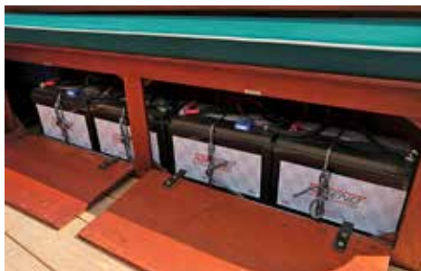
Batterierna är jämnt fördelade på båda sidorna.
