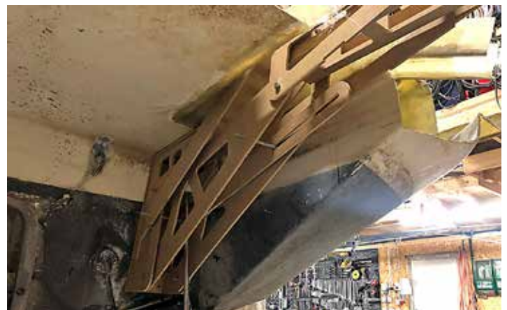
Fästet till den höj- och sänkbara konstruktionen för badbryggan sett underifrån.
