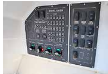
Båten har en imponerande elpanel i främre kabin med perfekt översikt över säkringar, brytare, huvudbrytare och övervakningsinstrument.
