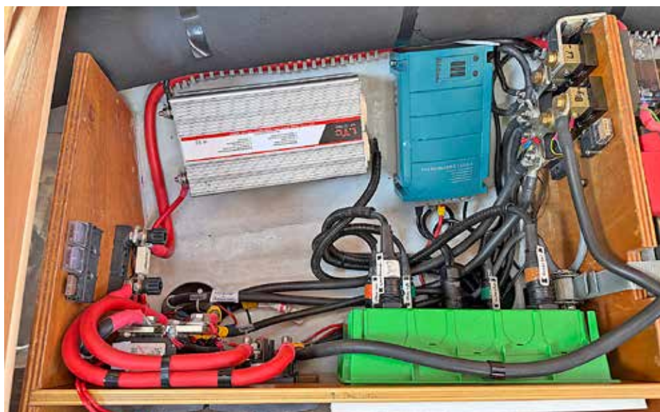
Alla nya elkablar är markerade med rött. En del äldre utrustning som till exempel inverter sitter kvar.
