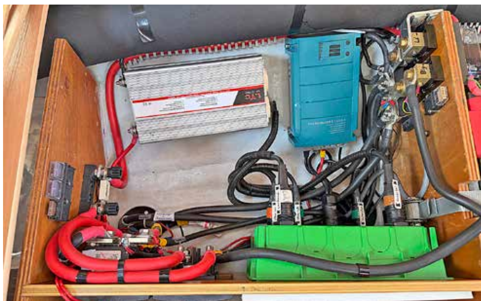
Alla nya elkablar är markerade med rött. En del äldre utrustning som till exempel inverter sitter kvar.
